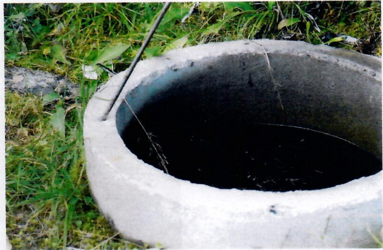
De källor som ligger vid boställen som fortfarande utnyttjas är i regel ordningsställda med betongring täckt med ett trälock.
